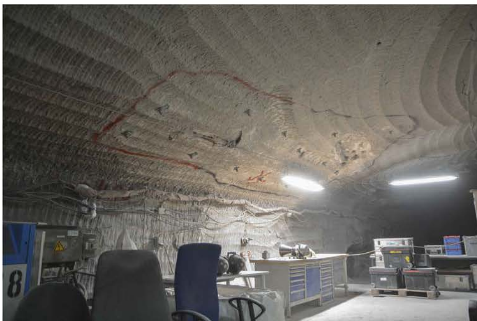
Abbildung 4.10: Fotoaufnahme des südlichen zentralen Bereichs vom Abbau 4/490, Übergang Stoß Firste, konturnahe Schädigungsbildung mit Ankersicherung vom 04.04.2018
