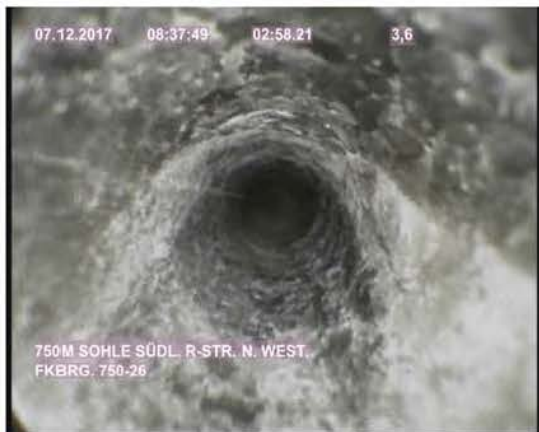
Bild 14: Geschlossener potentieller Riss (FKBrG.750-26, Teufe: 3,60 m)
