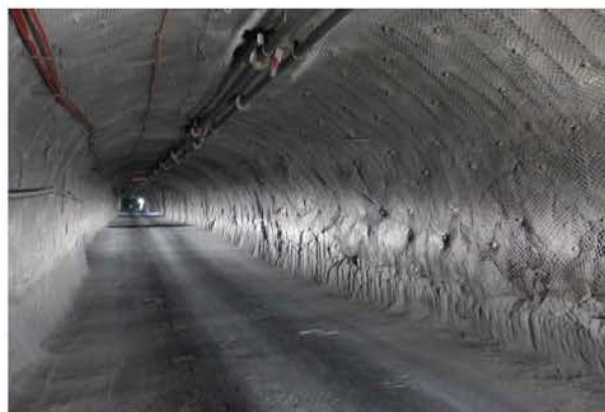
(b) Entfestigter Süd- und Nordstoß des Wendelstreckenabschnitts unterhalb des Querschlags zum Hauptgesenk I westl. mit beanspruchter Systemankerung
