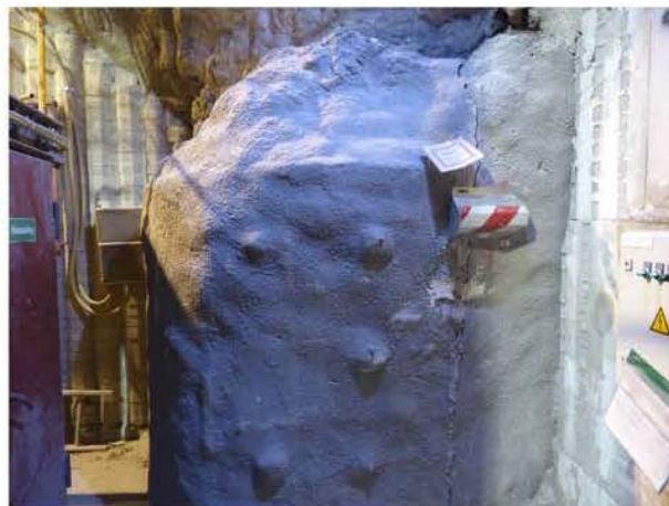
(b) Vertikalriss in Spritzbetonstabilisierung am südwestlichen Füllortpfeiler mit Fissurometer 053F (ehem. GM8/750), Blick nach Südwesten (14.12.2017)
