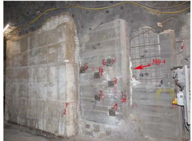
(b) Stabilisierter südöstlicher Füllortpfeiler nach Einbau von Mörtelinjektionsankern und Erstellung einer bis zum Übergang Stoß/Firste reichenden Stützmauer, Blick nach Nordwesten (23.11.2017)
