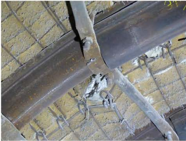
(a) Im nördlichen Überlappungsbereich der Profil-segmente gerissener Abstandshalter und lokal austretende Hinterfüllung, Blick nach Nordosten, 16.02.2018
