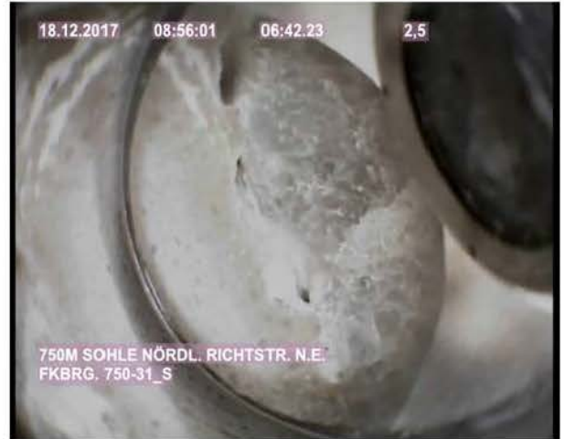
Bild 43: FKBrG. 750-31 – Position bei ca. 2,45 m Übergang Steinsalz–Sorelbeton Öffnungsweite ca. 4 mm
