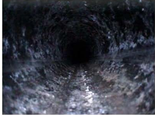
Bild 2: Bohrung 658010; Ausblühungen und Dunkelfärbung der Bohrlochkontur bei 24,8 m Bohrlöchentiefe deuten auf Feuchtigkeit hin; Aufnahme vom 13.12.2017
