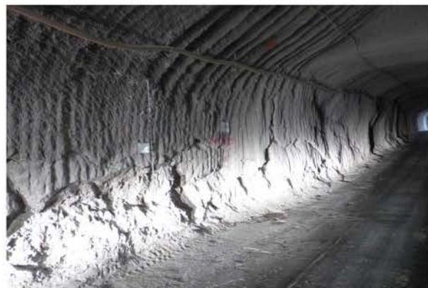
(b) Signifikant entfestigter Nordstoß der Wendelstrecke auf Höhe zwischen Abbau 7 und Abbau 8 auf der 595-m-Sohle
