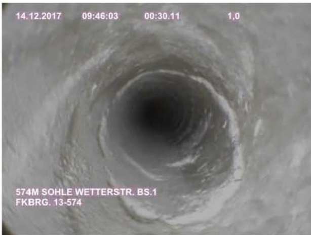
Bild 8: FKBrg. 13/574 – Riss bei 1,0 m
