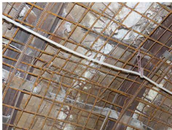
(b) Abgerissene Abstandshalter und austretende Hinterfüllung des Gleitbogensausbaus, Blick nach Nordosten, 16.02.2018
