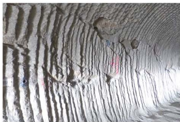
(b) Östlicher Wendelstreckenabschnitt von der 725-m- zur 750-m-Sohle mit zunehmender Ausbildung steil einfallender Abschalungen bis zum Übergang Nordstoß zur Firste
