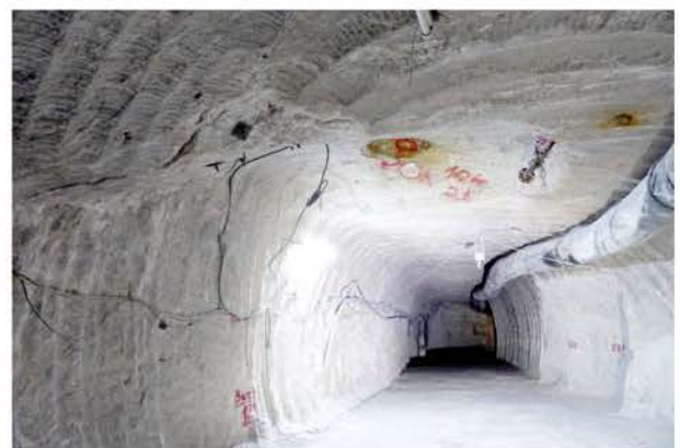
(b) Aufweitung des geräumten Querschlags mit geankertem Löser im östlichen Firstübergang, Blick nach Süden, 16.02.2018
