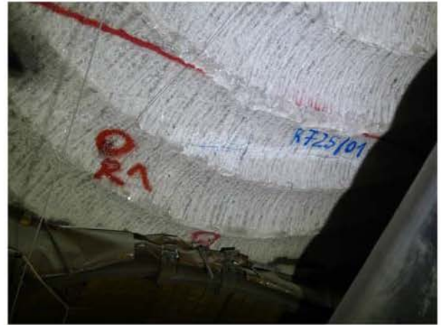
(b) Quer zur Richtstrecke im Pfeiler 1/2 verlaufender Firstriss westlich des Gleitbogenausbaus von Abbau 2, Blick nach Südosten, 16.02.2018
