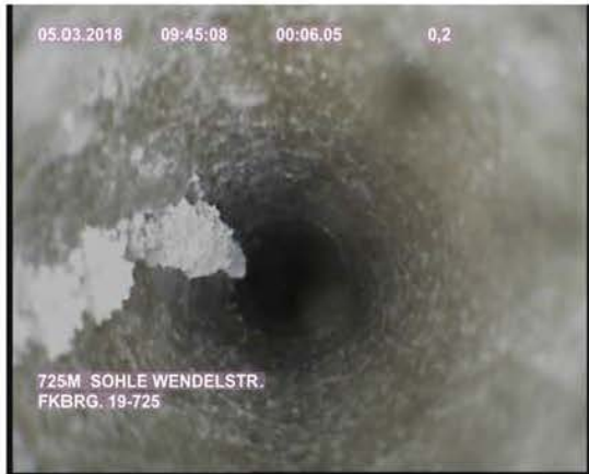
Bild 10: Salzausblühungen in feuchter Kontur (FKBrG.725-19, Teufe: 0,20 m)
