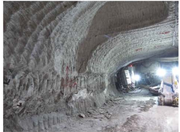
(b) Entfestigter Nordstoß zwischen Wettertor und Abzweig 2. nördliche Richtstrecke nach Osten vor dem Nachschnitt, Blick nach Osten, 14.12.2017
