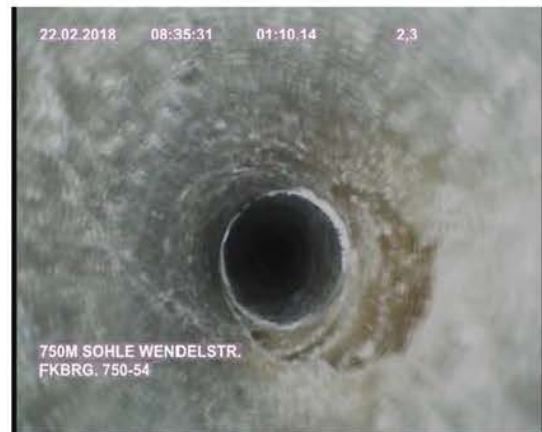
Bild 13: Riss mit geringer Öffnungsweite (FKBrG.750-54, Teufe: 2,40 m)
