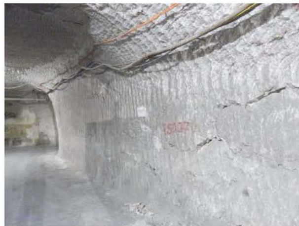
(b) Bis zum Übergang Stoß/Firste geschädigter Südstoß der nördlichen Richtstrecke nach Westen zwischen westl. Umfahrung und Schacht 4/750, Blick nach Südosten (04.12.2017)
