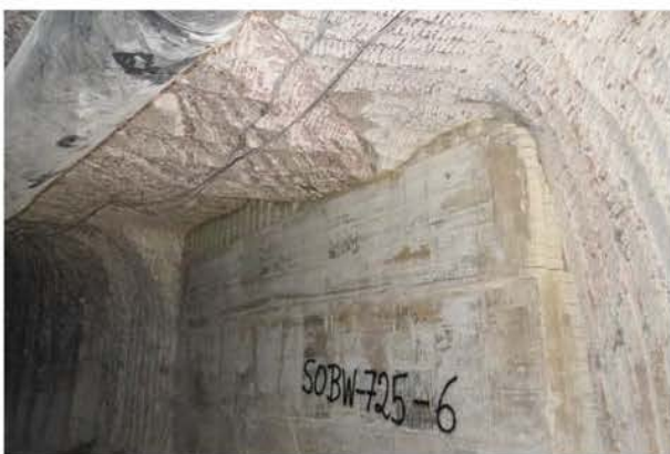
(a) Geankerte Schichtgrenze Na3 \beta /K2C und verfüllter Zugang zu Abbau 4/725, Blick nach Nordosten, 16.02.2018
