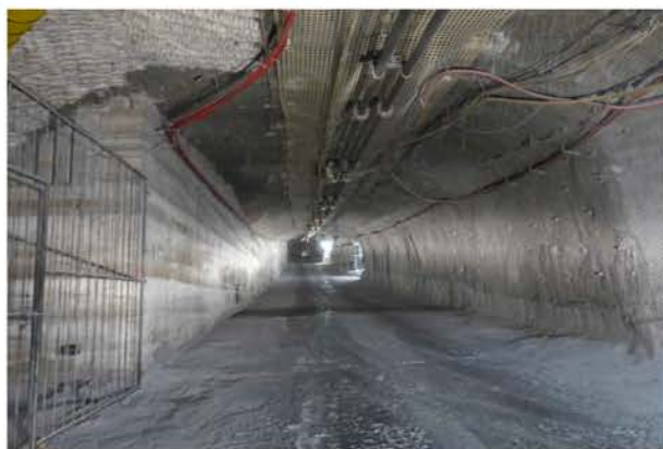
(a) Vom Querschlag zum Hauptgesenk I westl. bis zum Übergang zur 700-m-Sohle ausgebaute Stabilisierungsmauer am Nordstoß
