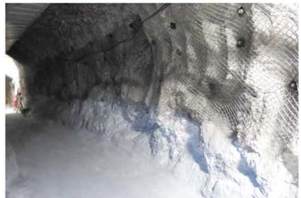
(b) Entfestigter Nordstoß der nördlichen Richtstrecke nach Osten, östlich des Querschlags zur 2. nördlichen Richtstrecke, Blick nach Westen, 23.11.2017
