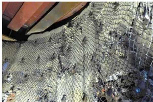
(b) Schachtausbau mit Rissen, Abplatzungen und defektem Anker unterhalb der Füllortbühne, Oststoß Schacht 2 / 750 (16.01.2018)
