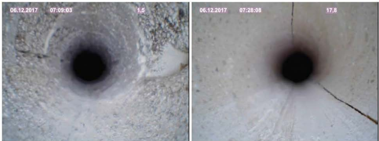
(a) Riss in der östlichen und westlichen Bohrloch- (b) Riss in der westlichen Bohrlochwand und in der wand Firste
