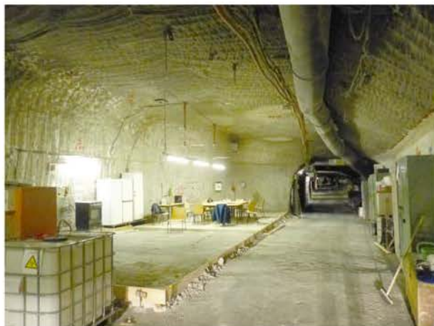
(a) Ertüchtigung der Sohle mit Sorelbeton im Bereich des Pausenplatzes, Blick nach Osten, 24.05.2017
