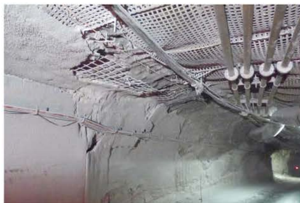
(b) Südstoß mit schadhafter Spritzbetonsicherung und Abschalungen im Übergang 637-658-m-Sohle
