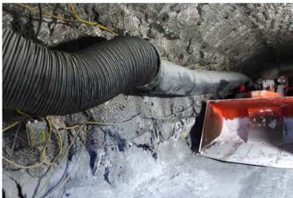
(a) Entfestigter Südstoß der nördlichen Richtstrecke nach Osten, westlich des Abzweigs zur Faktenerhebung, Blick nach Westen, 23.11.2017
