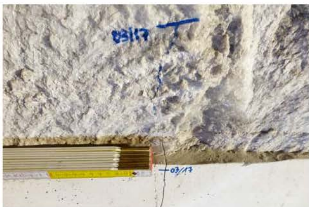
(a) Wieder aktivierte Risse am südöstlichen Füllortstoß verlaufen nach Nachschnitt bis in die Sorel-betonelemente des verfüllten Luttenkanals, Blick nach Südosten (14.12.2017)
