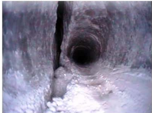
Bild 6: Bohrung 595006; Riss bei 29,4 m Bohrlöchentiefe; Aufnahme vom 15.12.2017
