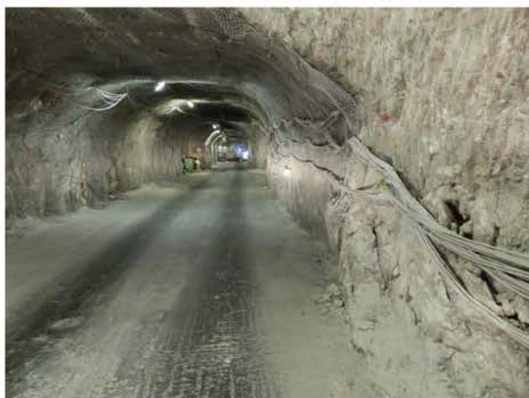
(a) Intensive Abschalungen im Bereich der Richtstrecke nach Osten im Firstniveau auf Höhe der Abbaue 12-13, Blick nach Osten, 19.03.2018
