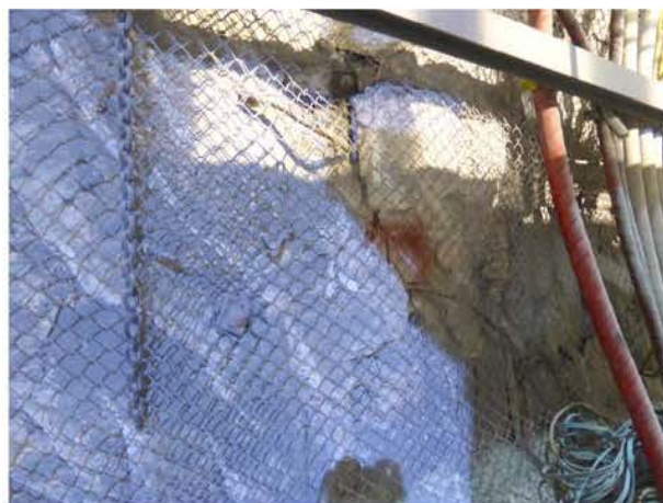
(b) Zunehmende Rissbildungen und Abplatzer am mit Maschendrahtverzug gesicherten Pfeilerstoß, Blick nach Nordosten (14.12.2017)
