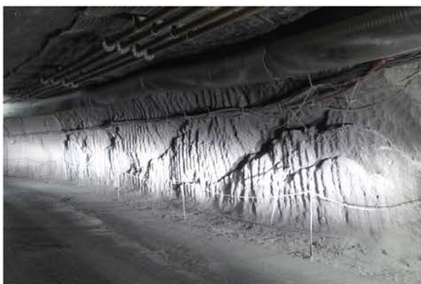
(a) Abgesperrter intensiv geschädigter Südstoß der Wendelstrecke zwischen entfestigter Spritzbetonsicherung und Nische
