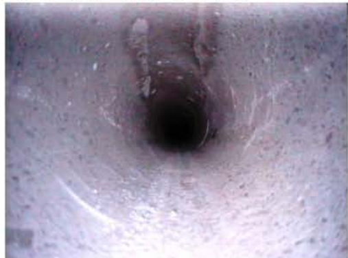
Bild 4: Bohrung 637013; Ausblühungen deuten auf Feuchtigkeit bei 35,80 m Bohrlöchentiefe; Aufnahme vom 14.12.2017
