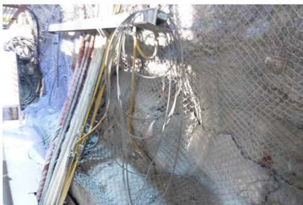
(a) Intensiv entfestigter südlicher Stoß des nördlichen Füllortpfeilers von Schacht 2/750 mit Rissen und Abschalungen, Blick nach Nordwesten (14.12.2017)
