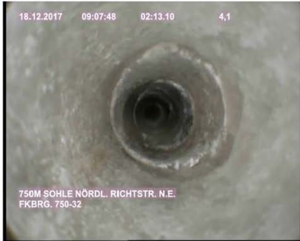
Bild 46: FKBrG. 750-32 – Position bei 4,1 m Aufgelockerter Bereich bis 4,5 m
