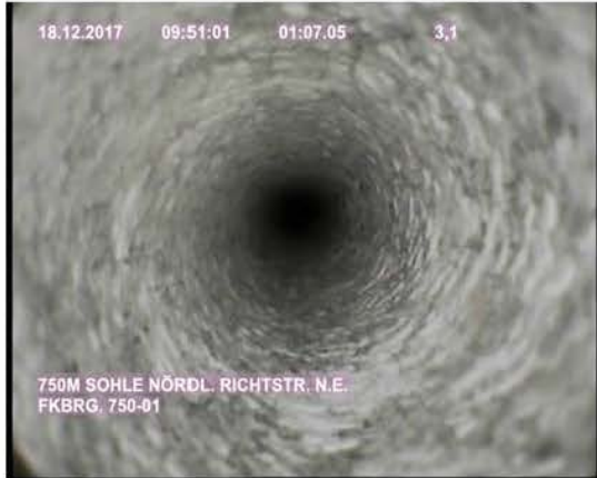
Bild 34: Spuren des Bohrvorgangs und anhaftendes Bohrmehl (FKBrg.750-01, Teufe: 3,10 m)
