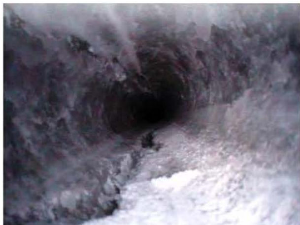
(a) Beginn der Rissstruktur bei ca. 9,80 m
