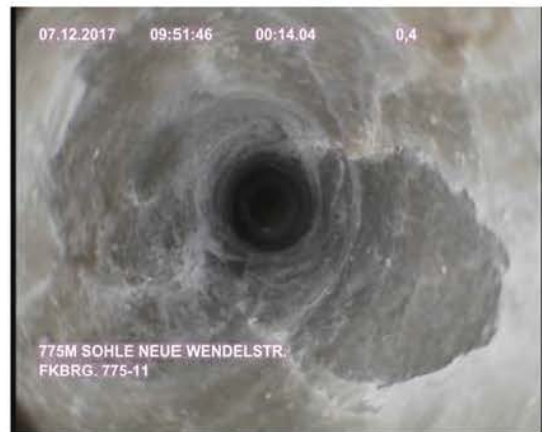
Bild 15: Potentieller Riss an Schichtgrenze (FKBrG.775-11, Teufe: 0,40 m)
