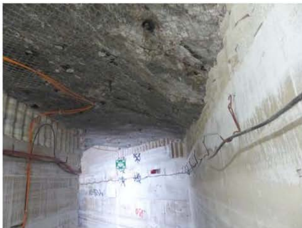
(a) Zugang zum Füllort Schacht 4/750 mit geschädigter und durch Systemankerung mit Maschendrahtverzug gesicherter Firste sowie Stützbauwerken an den Stößen, Blick nach Südwesten (04.12.2017)
