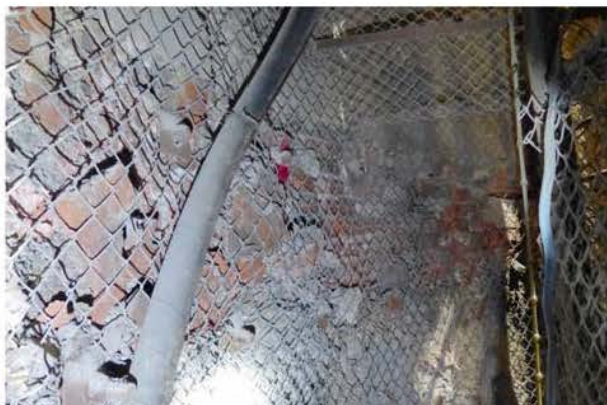
(a) Mauerwerksausbau mit intensiven Abplatzern unterhalb der Füllortbühne, Weststoß Schacht 2 / 750 (16.01.2018)
