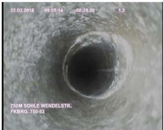
Bild 12: Riss mit Öffnungsweite von ca. 1 bis 2 mm (FKBrG.750-53, Teufe: 1,30 m)
