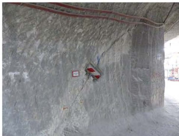
(b) Fissurometer 034F an einem in der Schichtung verlaufenden Riss am Nordoststoß im Einmündungsbereich der Wendelstreckenumfahrung
