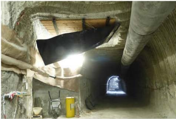
(a) Im Bereich von Rolloch R1 nachgeschnittene und gesicherte Firste sowie sanierte Katasterstelle P725005, Blick nach Osten, 16.02.2018
