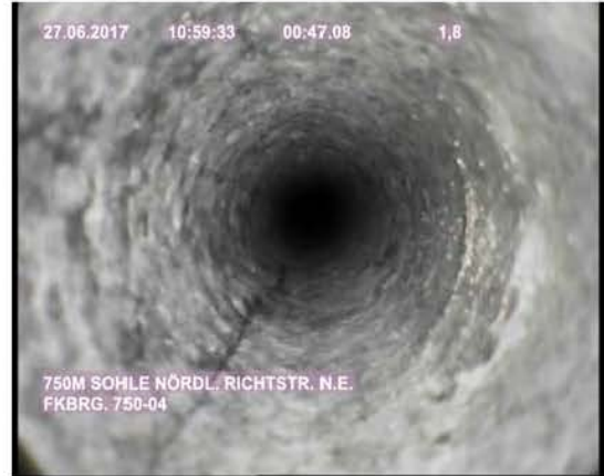
Bild 35: Beginnende Ausblühungen in leicht feuchter Bohrlochkontur (FKBrg.750-04, Teufe: 1,80 m)
