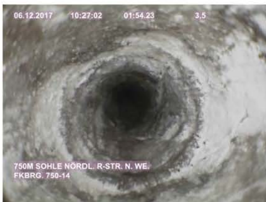
Bild 38: Spuren des Bohrvorgangs und anhaftendes Bohrmehl (FKBrg.750-14, Teufe: 3,50 m)
