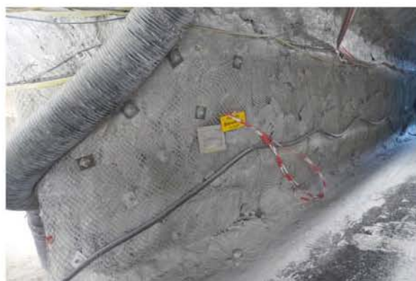
(b) Entfestigter Südstoß der Wendelstrecke westlich des Querschlags zum Blindschacht 2, Blick nach Südosten, 19.03.2018
