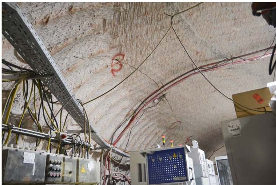
Abbildung 4.14: Fotoaufnahme des Risses im Pfeiler zwischen E-Werkstatt/490 und Abbau 8/490 vom 19.04.2018, Blickrichtung: Süd-West
