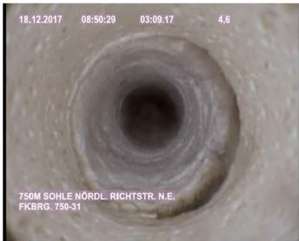
Bild 44: FKBrG. 750-31 – Position bei ca. 4,6 m Übergang Sorelbeton–Steinsalz mit Firstspalt, Öffnungsweite ca. 8 mm
