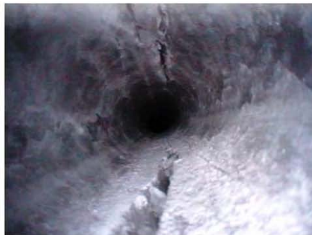
(b) Ende der Rissstruktur bei ca. 10,10 m
