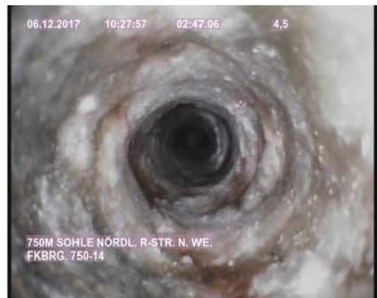
Bild 39: Salzausblühungen in feuchter Bohrlochkontur (FKBrg.750-14, Teufe: 4,50 m)
