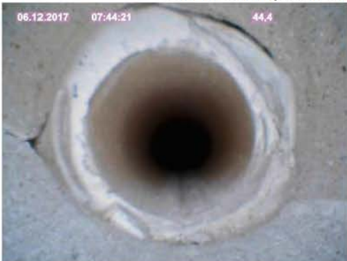
Bild 3: Bohrung 553014; Riss bei 44,6 m Bohrlöchentiefe; Aufnahme vom 06.12.2017
