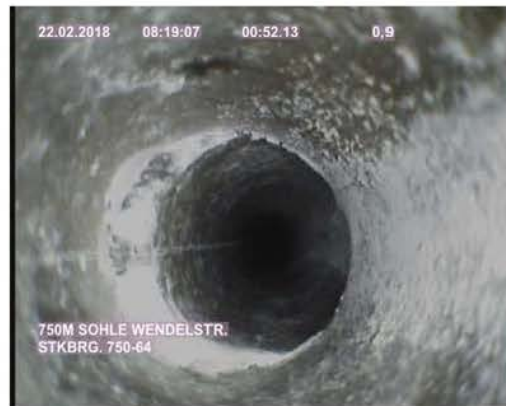
Bild 19: Riss mit Öffnungsweite von ca. 1 bis 3 mm, seitl. versetzt (StKBrg.750-64, Teufe: 0,90 m)
