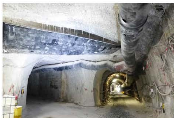
(b) Partiiell nachgeschnittener Pfeiler 3/4 mit Tropfstellen am Rollloch R2 und Abzweig des Querschlags nach Norden, Blick nach Osten, 16.02.2018
