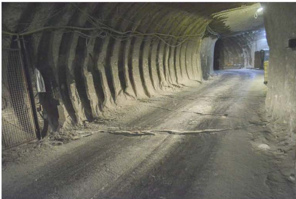
Abbildung 4.25: Fotoaufnahme der Rissbildungen auf der Sohle in der Zufahrt zur Bohrwerkstatt auf der 511-m-Sohle (Pfeiler 2/3) vom 09.03.2018. Blickrichtung: Südost
