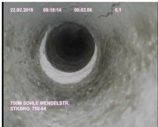
Bild 18: Riss mit Öffnungsweite von ca. 2 bis 4 mm, seitl. versetzt (StKBrg.750-64, Teufe: 0,10 m)
