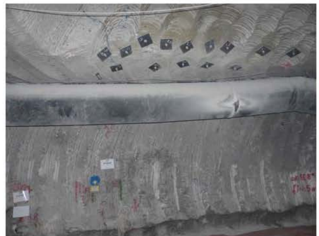
(b) Von Rissen durchzogener und mit Ankern gesicherter Firstüberhang und Vertikalrisse am Südstoß von Pfeiler 2/3, Blick nach Süden, 16.02.2018
