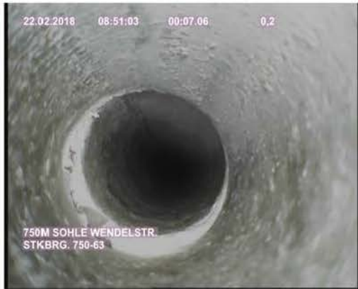
Bild 16: Riss mit Öffnungsweite von ca. 1 bis 2 mm, seitl. versetzt (StKBrg.750-63, Teufe: 0,20 m)
