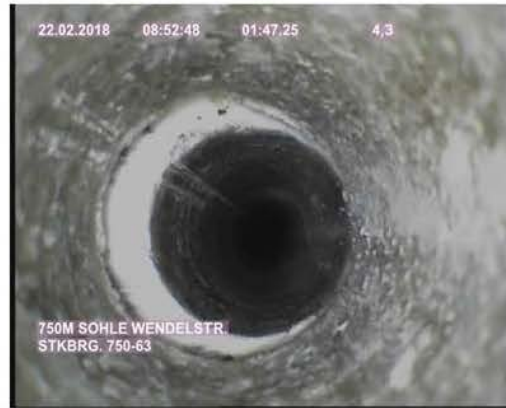
Bild 17: Riss mit Öffnungsweite von ca. 5 bis 6 mm, seitl. versetzt (StKBrg.750-63, Teufe: 4,20 m)
