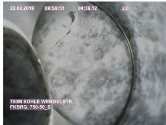
Bild 11: Riss mit Öffnungsweite von ca. 1 bis 2 mm (FKBrG.750-50, Teufe: 1,90 m)
