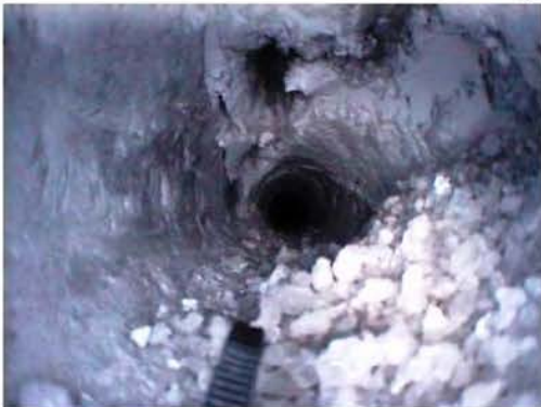
Bild 5: Bohrung 595006; Riss und Konturausbrüche bei 27,1 m Bohrlöchentiefe; Aufnahme vom 15.12.2017
